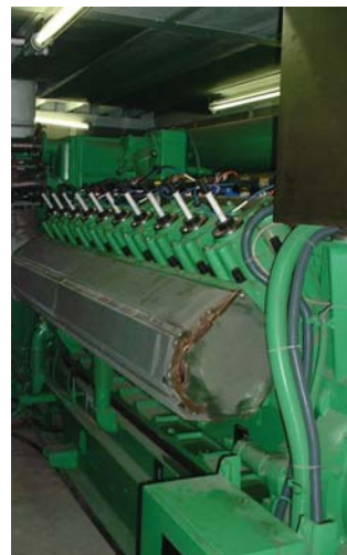
motore del cogeneratore
